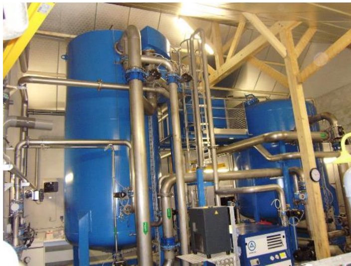
Figure 10 : Photo de la station de traitement – A gauche, le Nitrazur ® et à droite, le Carbazur ®
